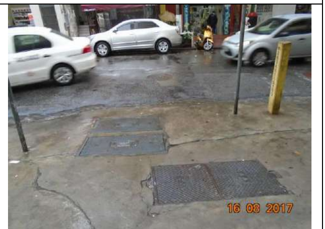
Foto 35: Ao longo do traçado foram verificadas tampas de acesso de diversas concessionárias de serviços, ocupando o subleito da via. Próximo à esquina entre as ruas Aureliano Coutinho e Baronesa de Itu.
