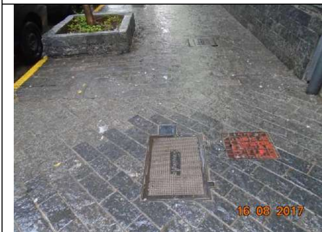
Foto 34: Ao longo do traçado foram verificadas tampas de acesso de diversas concessionárias de serviços, ocupando o subleito da via. Próximo à esquina entre as ruas Aureliano Coutinho e Baronesa de Itu.
