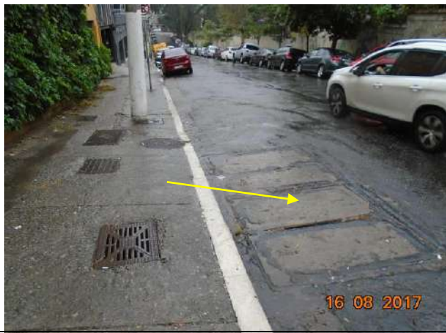
Foto 18: Poço de Visita da Eletropaulo na Rua Coronel José Eusébio.
