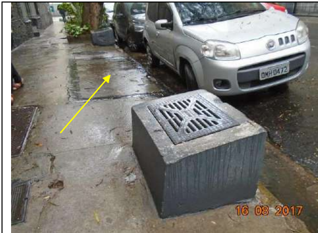
Foto 30: Poço de Visita da Eletropaulo.
