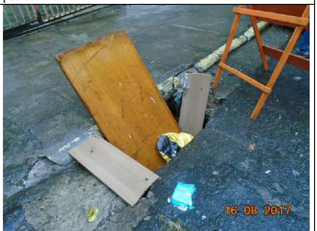
Foto 29: Bueiro danificado e obstruído por resíduos sólidos ao longo do traçado. Também foram constatados diversos pontos onde a drenagem danificada ou ineficiente provoca acúmulo de água nas vias.
