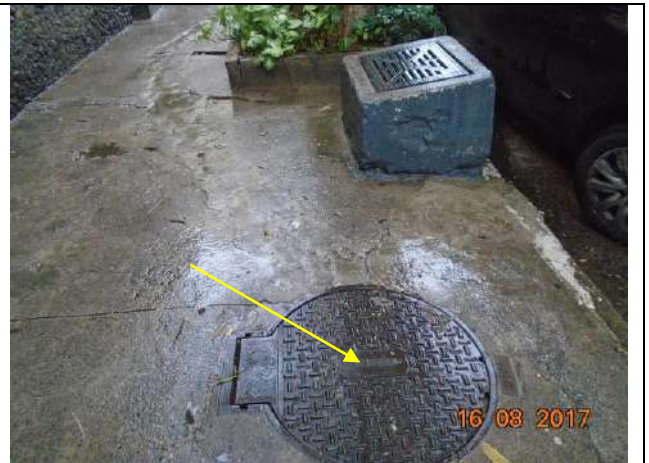
Foto 31: Poço de Visita da Eletropaulo.
